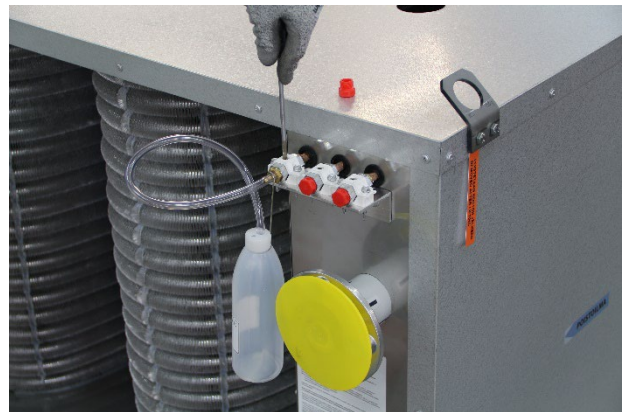
Avaa ilmaushanaa hieman, jolloin ilma pääsee poistumaan LTO-laitteesta
