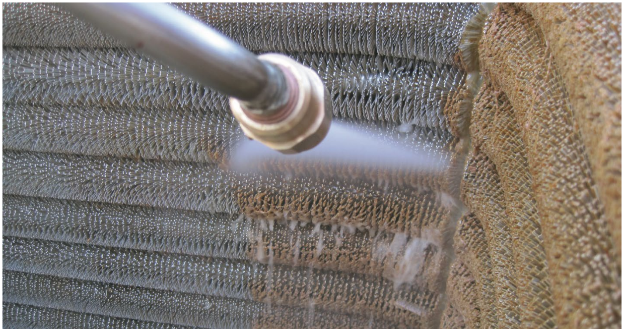
McDonald's rasvahuuvun LTO-huippuimurin neulapinnan pesu.
